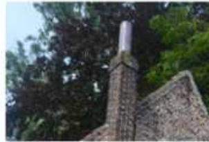
Schoorsteen vermoedelijk asbesthoudend
