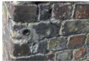
restanten sluiting poort, roestig
