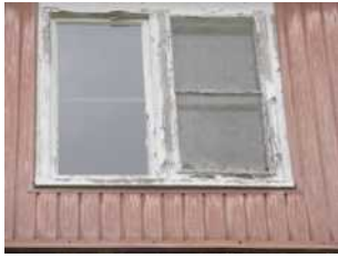
afschilfering van de verf op houten bekleding en raamkaders.
