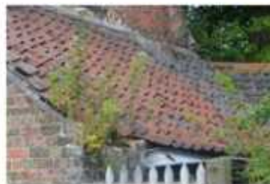
plantengroei in metselwerk zinken dakgoot losgekomen en deels ontbrekend
