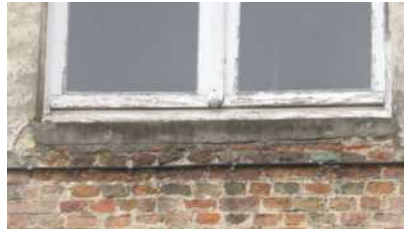
Dorpels zijn zwart van het vuil + cementmortel brokkelt af aan de onderhoeken van de raamkaders
