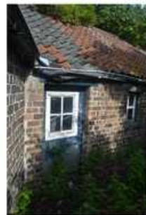
zinken dakgoot beschadigd
