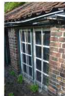
zinken dakgoot beschadigd
