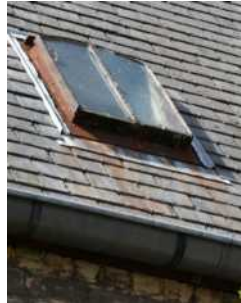
Ramen zijn heel verroest en zorgen voor een roestige uitloop op het leien dak.
